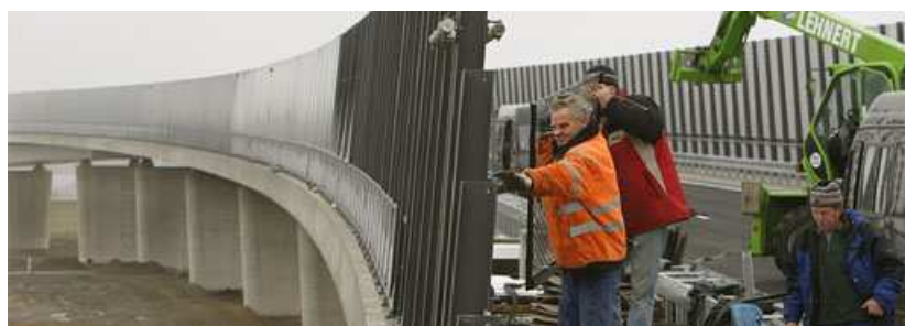
Die Mühlberger Brücke noch während der Montage: Mehr als 120 Teile der massiven Plexiglasverkleidung riss der Tornado am Pfingstmontag heraus.
